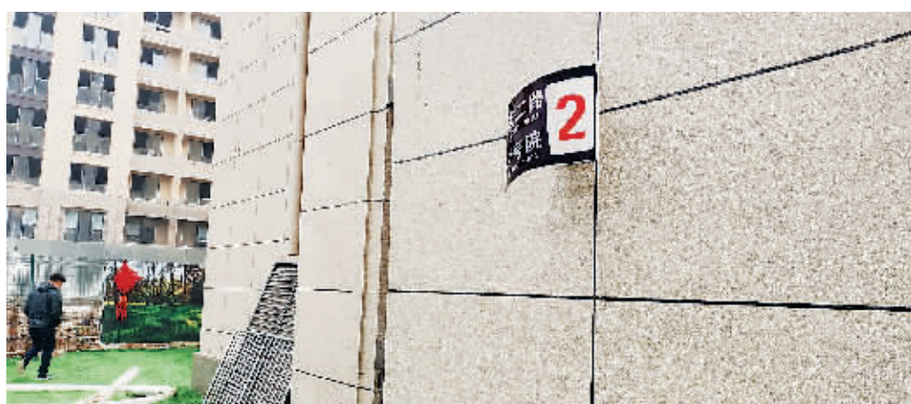
和悦华锦项目一期楼栋标识脱落
