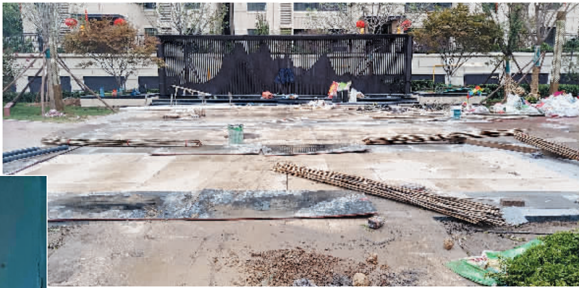
小区楼座边塌陷导致的裂缝随处可见，多处地面高低不平。
