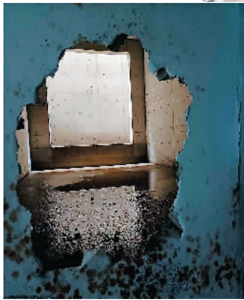
地下室排水管凿开的大洞。
